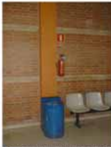
Medida contra incendios: extintor
