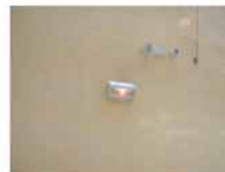
Iluminación de emergencia
