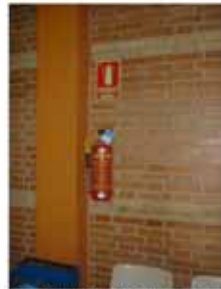
Medida contra incendios: extintor
