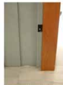
Ascensor: puerta en planta de acceso
